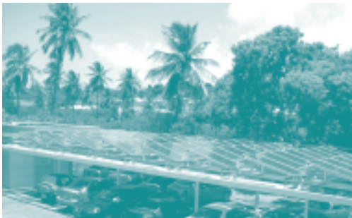
▲ 圖2 Almond Resort 安裝在停車場上方的面蓋式太陽能熱水器
